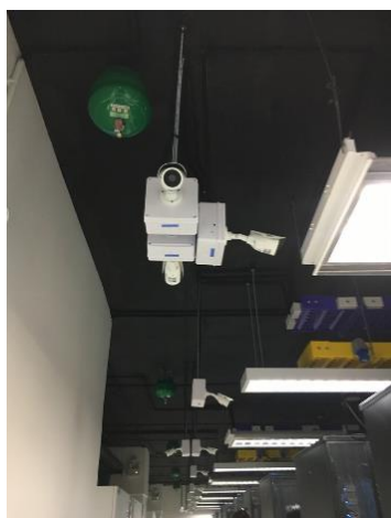
ระบบ CCTV
