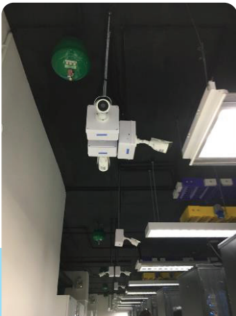
ระบบ CCTV
