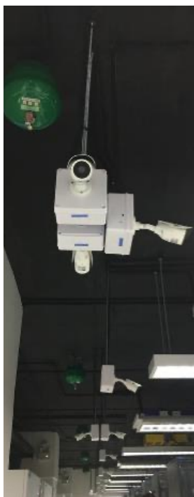
ระบบ CCTV
