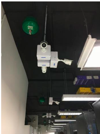
ระบบ CCTV
