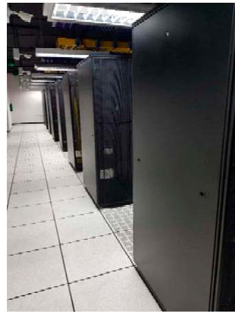
ระบบพื้น 2 ชั้น ยกพื้นสูงขึ้นเพื่องานระบบป้องกันการรั่วของน้ำที่อาจก่อให้เกิดความเสียหายกับอุปกรณ์คอมพิวเตอร์
